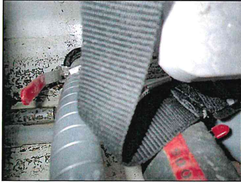
Photo 14 : vanne groupe électrogène
